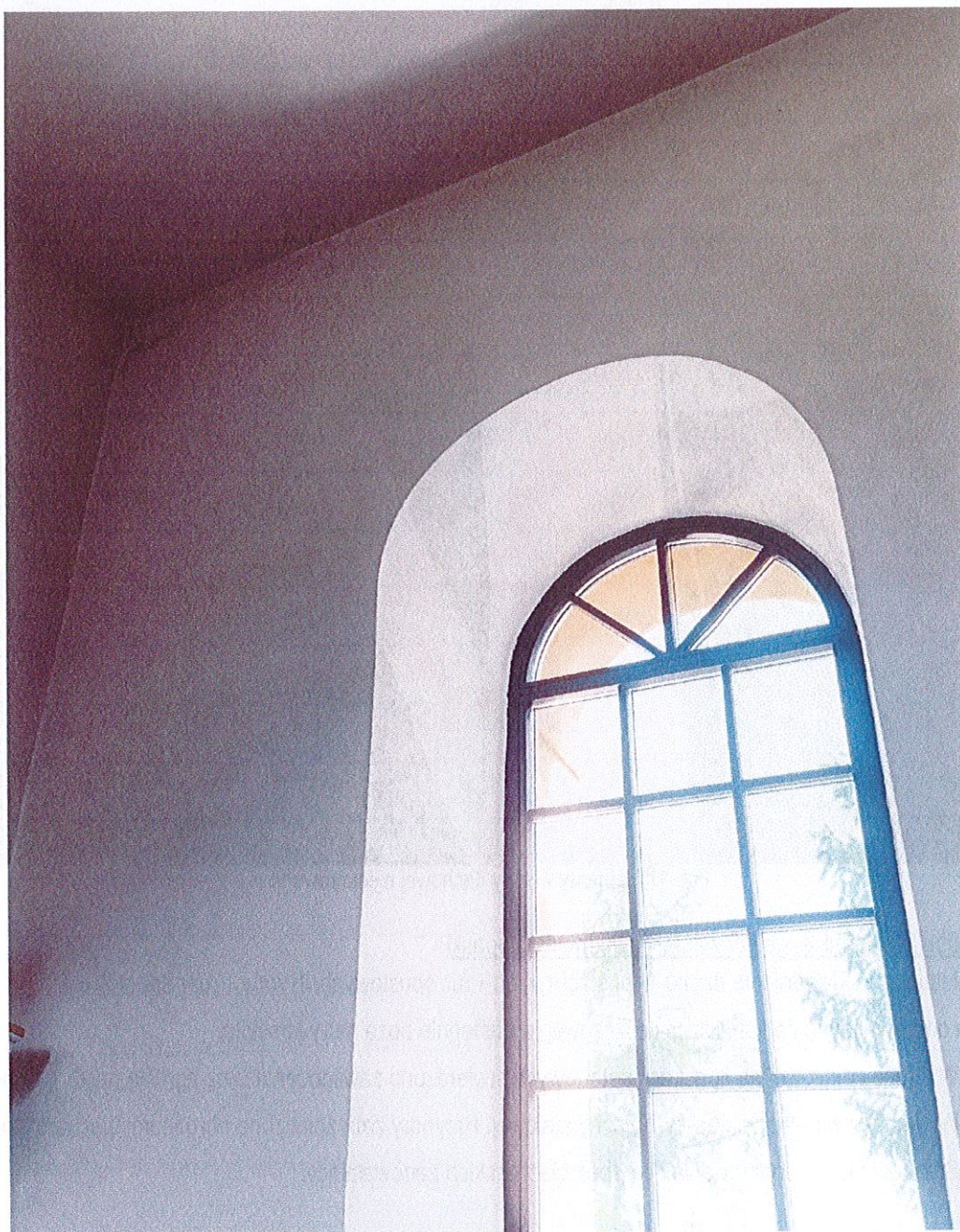
Fot. 18 Widok stolarki okiennej od wewnątrz. Widoczne ślady zabrudzeń w narożach ścian
