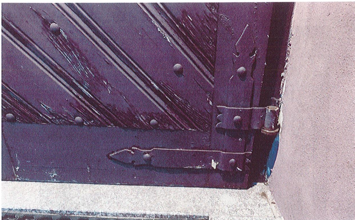
Fot. 21 Zawiasy pasowe oraz degradacja klepek
