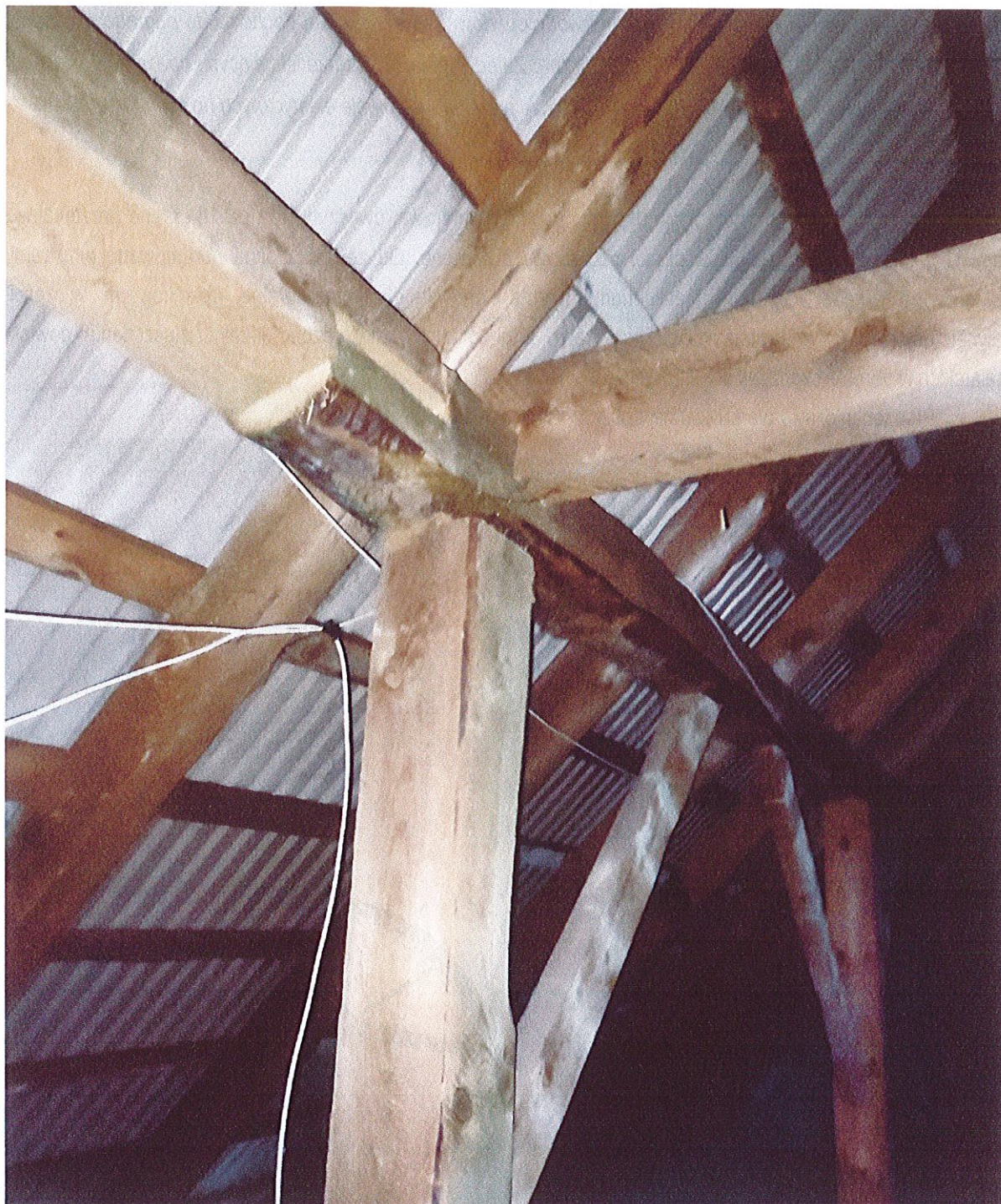
Fot. 17 Elementy więźby dachowej nieokorowane
