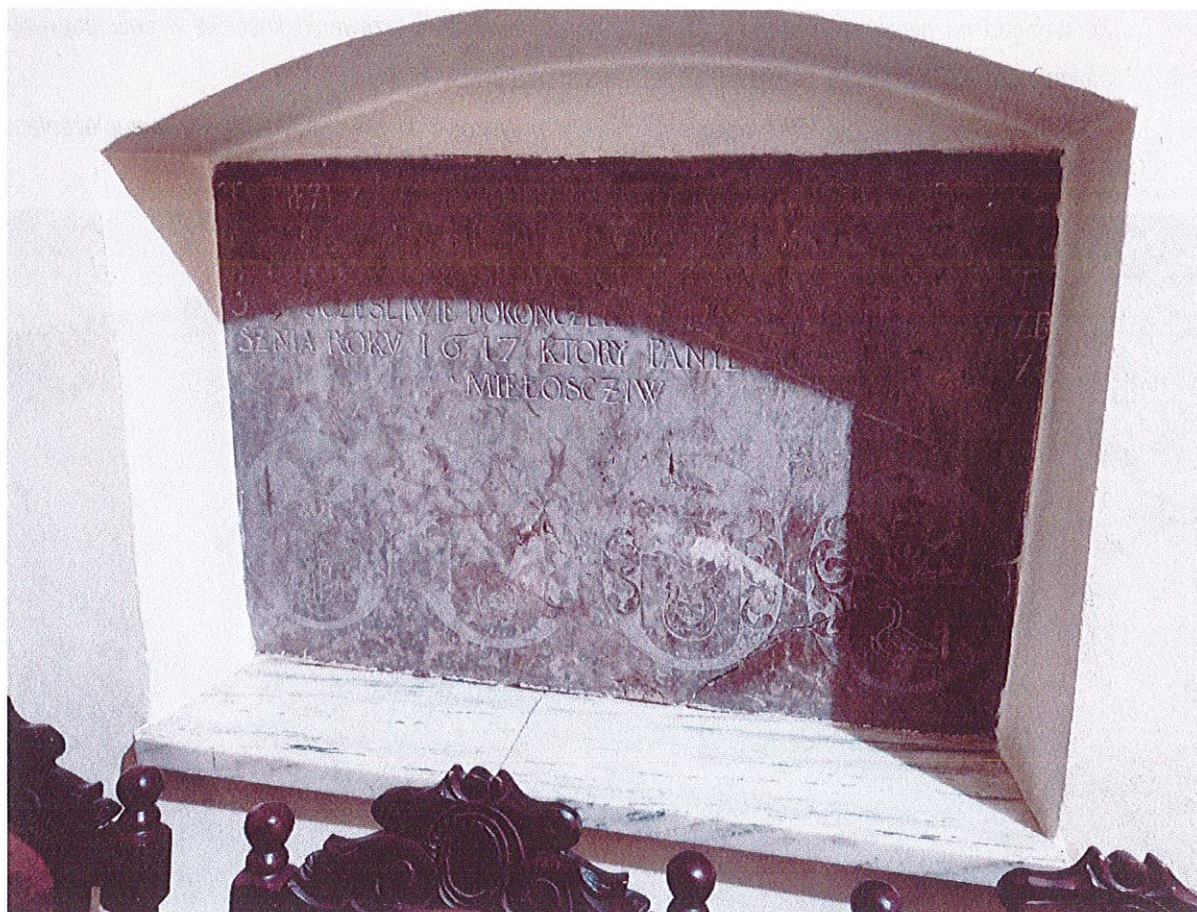
Fot. 11 Epitafium we wnęce ściany południowej prezbiterium. Prawy dolny narożnik odspojony. Część literactwa wypełniona farbą z etapu malowania ścian. Część herbów słabo widoczna.
